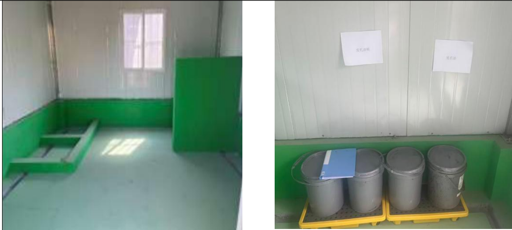
图 3-5 危废间及内部防渗
