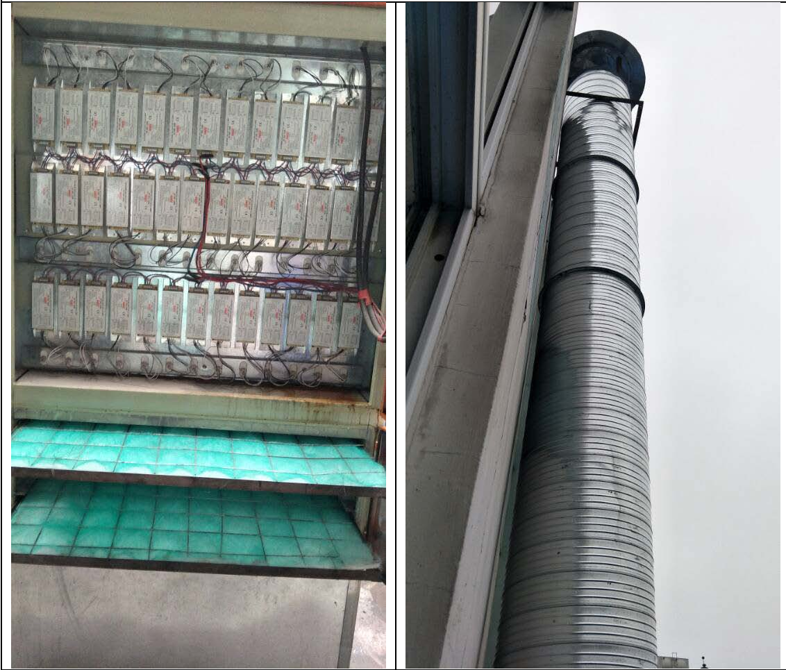
喷漆废气处理设施内部照片
